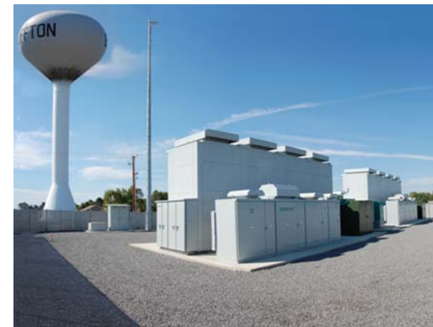
Sodium-Sulfur (NAS) Battery
