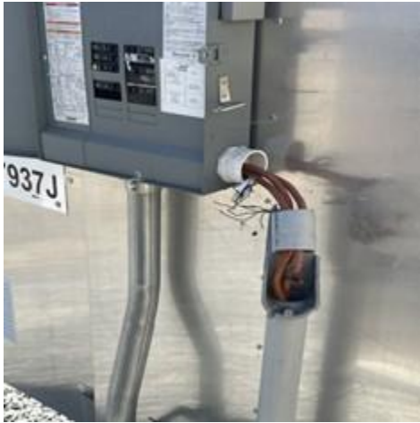
Carcasa de cables vandalizada que dejaba al descubierto los cables de señalización.
