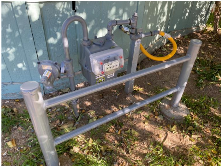
Foto de la instalación de gas recientemente mejorada en Tehachapi, CA.
